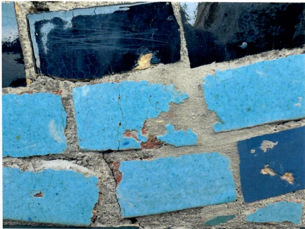
Fot. 20. Spękania i odspojenia szkliwa na powierzchni płytek.
