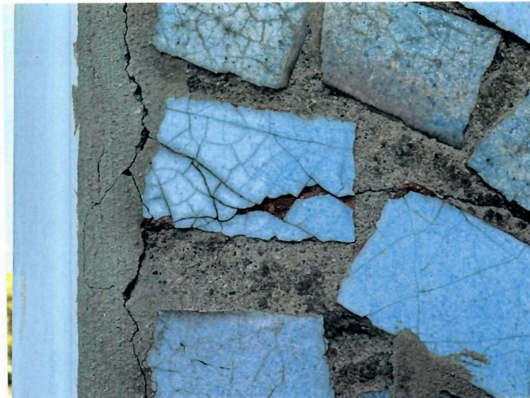
Fot. 18. Spękania i odspojenia szkliva na powierzchni płytek, pęknięcia na krawędzi mozaiki.
