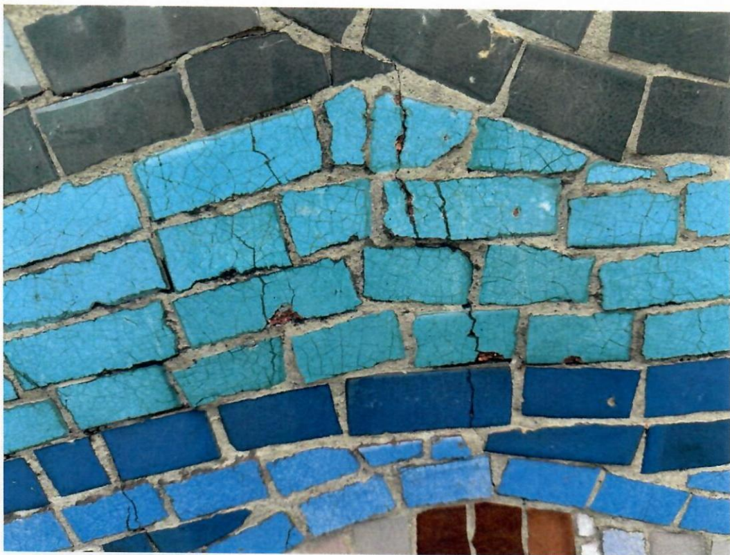
Fot. 4. Spękania i odspojenia szkliwa na powierzchni płytek.
