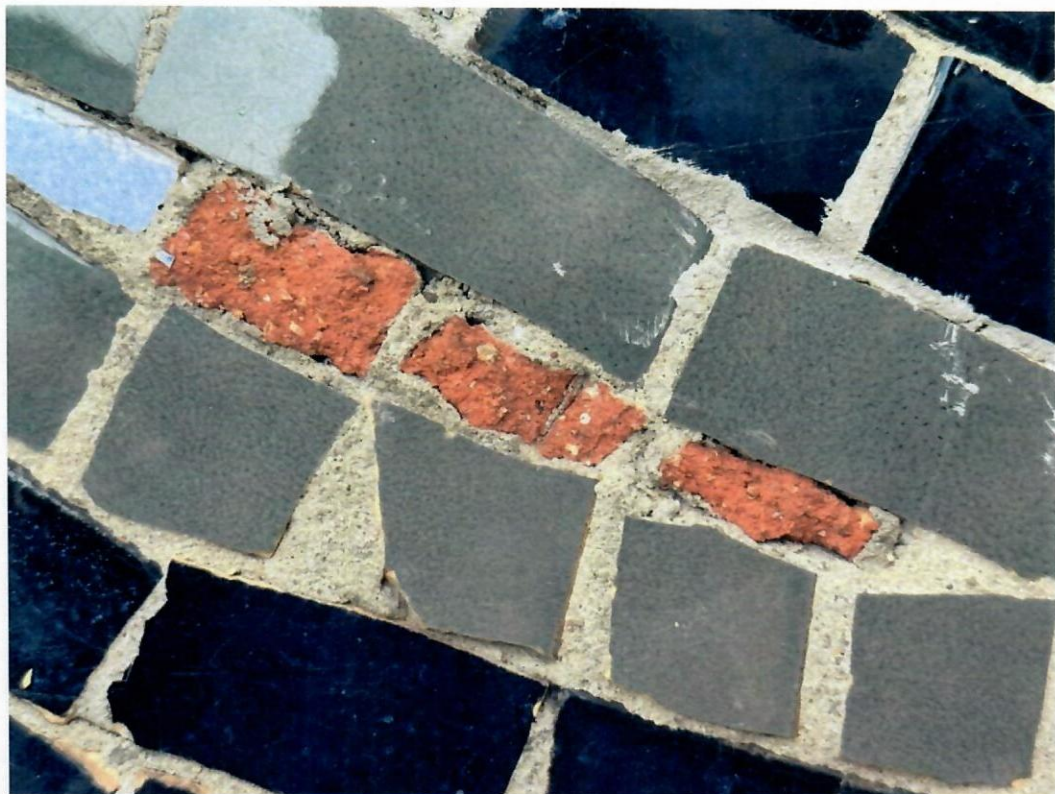
Fot. 22. Spękania i odspojenia szkliva na powierzchni płytek.
