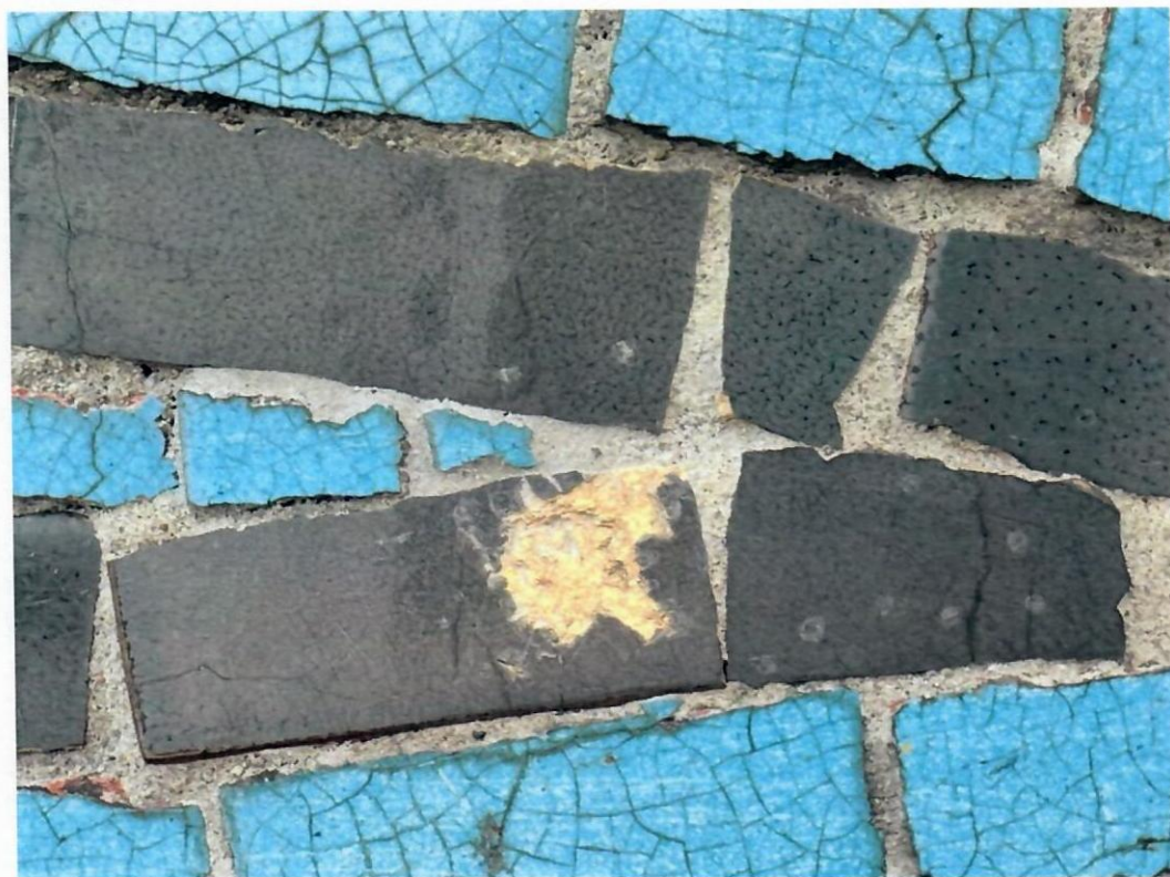
Fot. 19. Mechaniczne uszkodzenia szkliva na powierzchni płytek.
