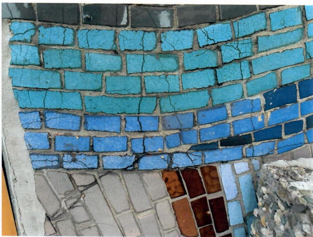
Fot. 5. Spękania i odspojenia szkliwa na powierzchni płytek.
