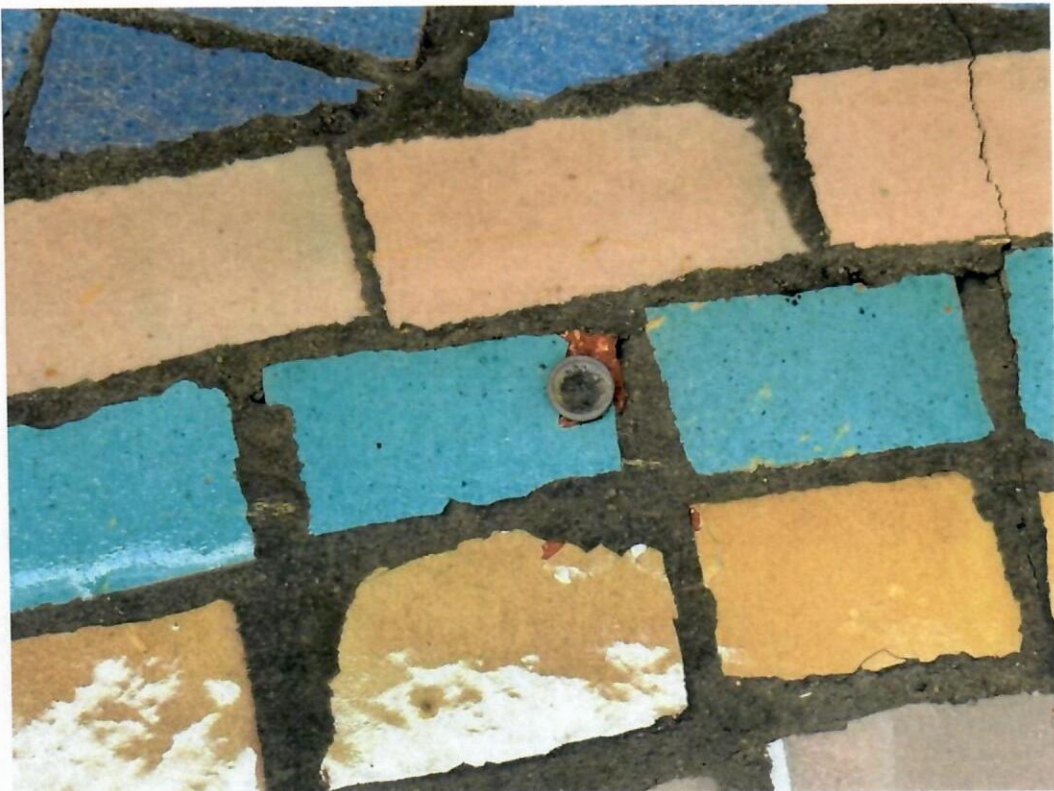
Fot. 12. Mechaniczne uszkodzenia szkliva na powierzchni płytek.
