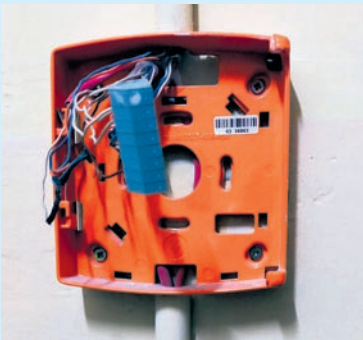
Zniszczenie systemu oddymiania w budynku przy ul. Z. Nałkowskiej 21 – koszt naprawy 12 000,00 zł.
