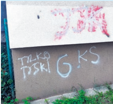
Graffiti na elewacji budynków przy ul. Z. Nałkowskiej 10-26 i 28-44 – koszt naprawy 1 580,00 zł.
