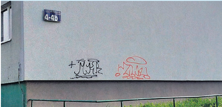
Graffiti na elewacji budynku przy ul. Z. Nałkowskiej 4, 4ab – koszt naprawy 830,00 zł.
