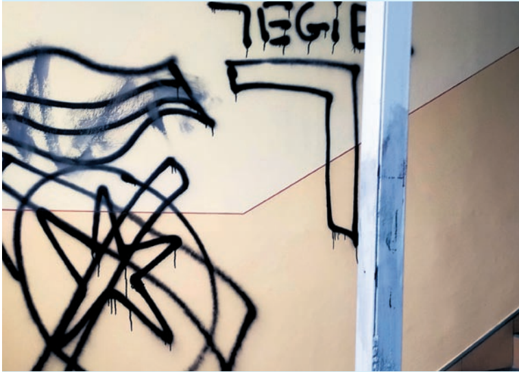
Zniszczenie ściany w klatce schodowej w budynku przy ul. Z. Nałkowskiej 4a – koszt naprawy 1 840,00 zł.
