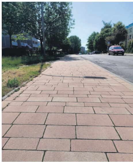
Jedną z inwestycji zrealizowaną w ramach budżetu obywatelskiego był remont chodnika przy ul. Orzeszkowej.
