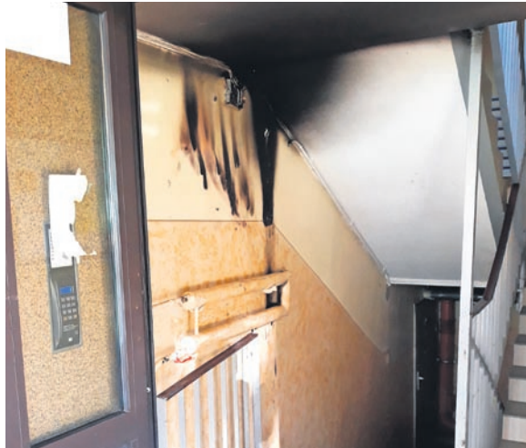
Podpalenie klatki schodowej (ul. E. Orzeszkowej 19).
